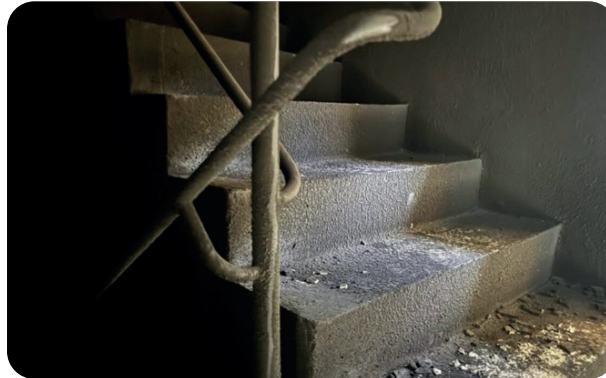
Fotoğraf 2. Yangın Sonrası Yangın Merdivenin Durumu (internet)
