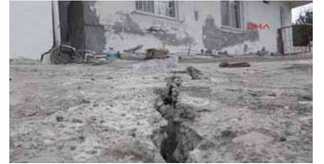
Şekil 3. Zonguldak'ın Kozlu ve Kilimli ilçelerinde maden faaliyetleri nedeniyle bazı evlerin tabanlarında çökme, duvarlarında çatlaklar oluştu. ( https://www.haberler.com/tasman-evsiz-birakti-6303575-haberi/ )
