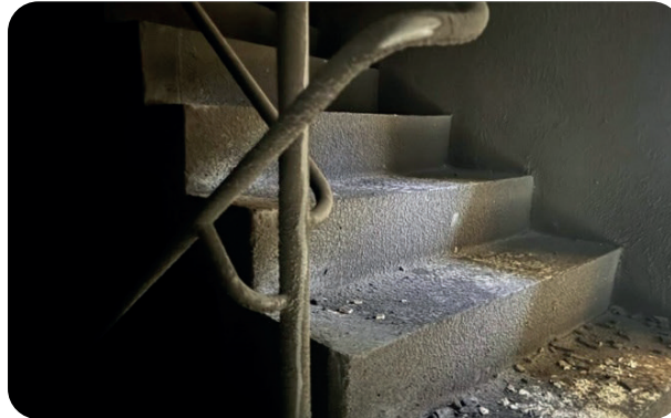
Fotoğraf 2. Yangın Sonrası Yangın Merdivenin Durumu (internet)
